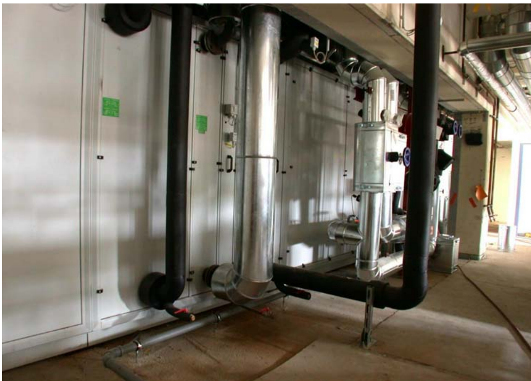
Bild 2-11: Zuluft-Zentralgerät mit Wärmerückgewinnung im Erdgeschoss
