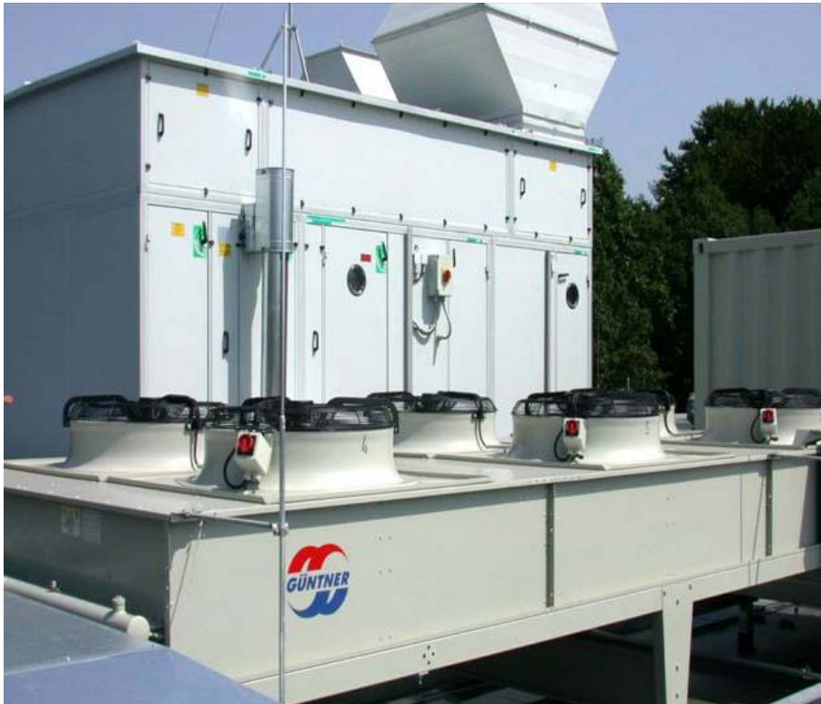
Bild 2-13: Freikühler (Vordergrund) und Abluftgerät mit Wärmerückgewinnung
