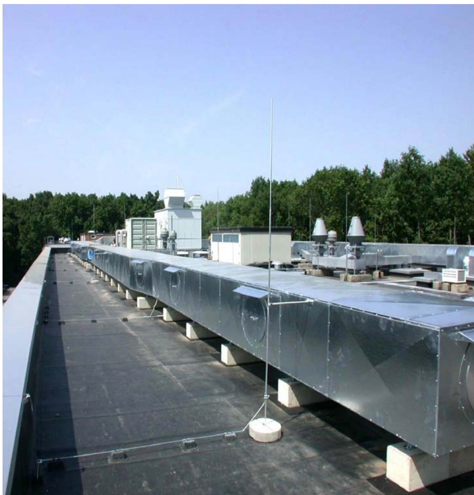
Bild 2-12: Abluftammelkanal auf dem Dach
